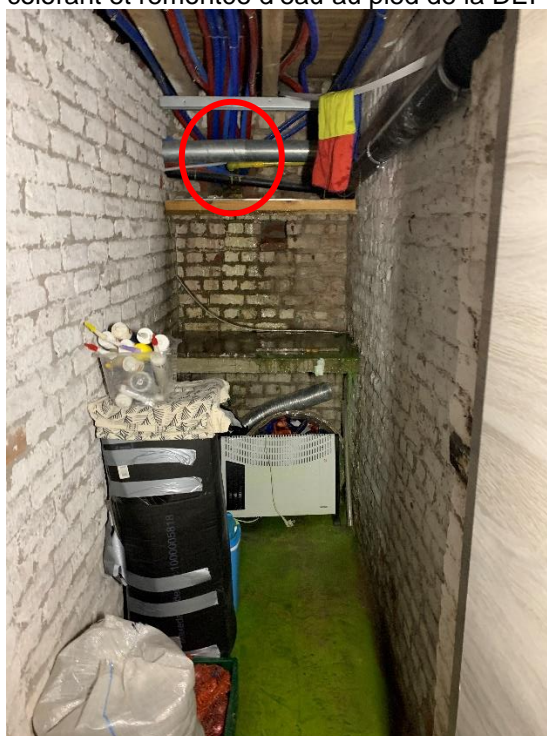
coulées d'eau dans la cave par le fourreau
