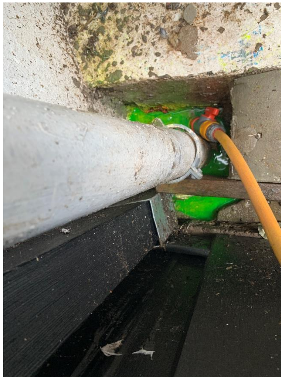
colorant et remontée d'eau au pied de la DEP
