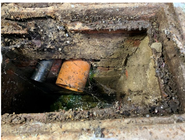
Au n°9 : Coulée d'eau entre les briques dans la CV
