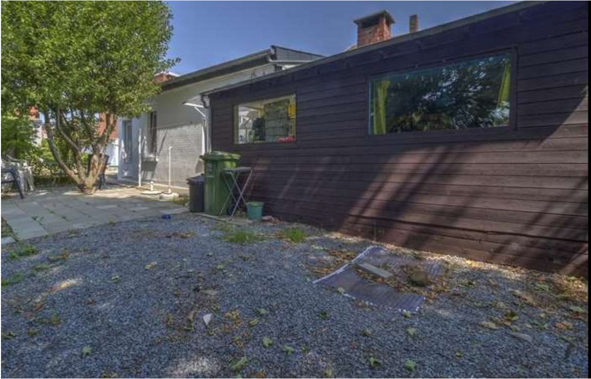
Pseudo fosse septique sous la bâche devant la seconde fenêtre
