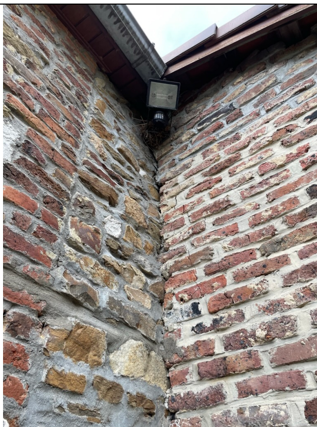
Photo 4 : fissure entre façade garage et façade maison
