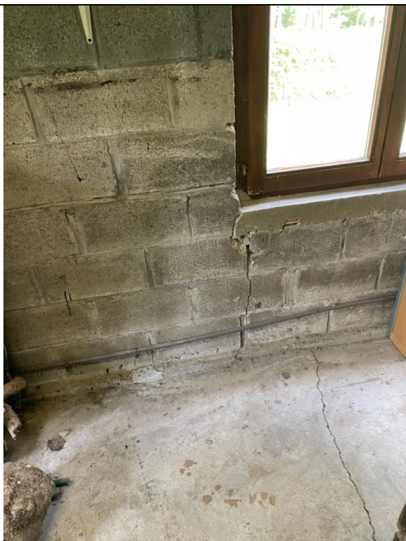
Photo 13 : fissures au sol et sous fenêtre garage extension arrière
