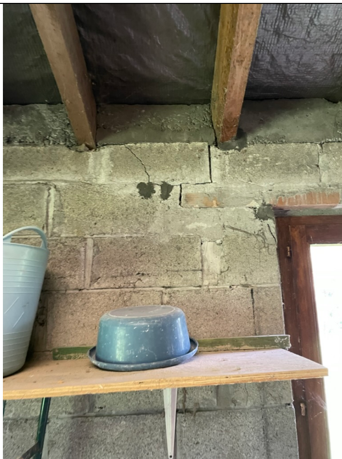
Photo 10 : fissures au mur aux appuis de la charpente
