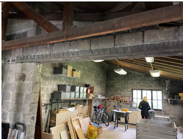
Photo 7 : Poutre béton avec importante flèche
