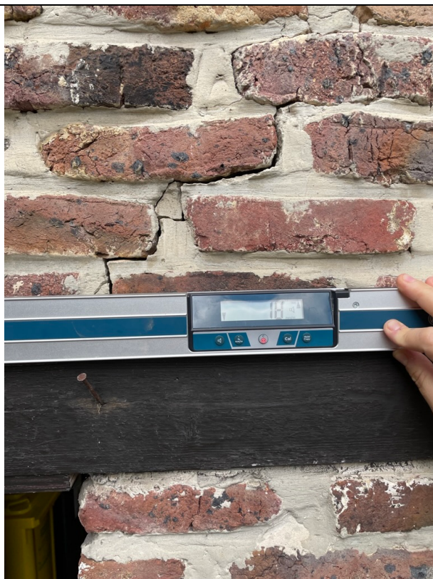
Photo 5 : inclinaison façade garage
