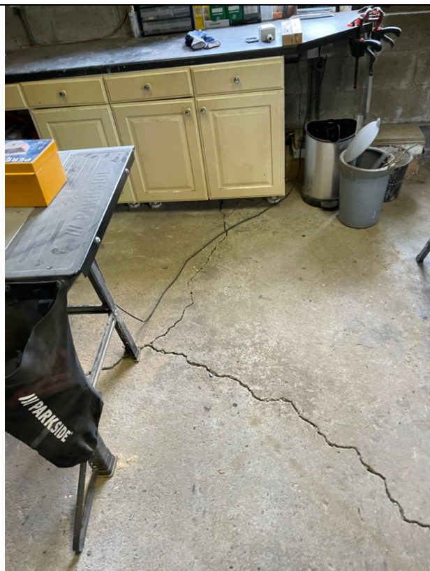
Photo 9 : fissures au sol garage
