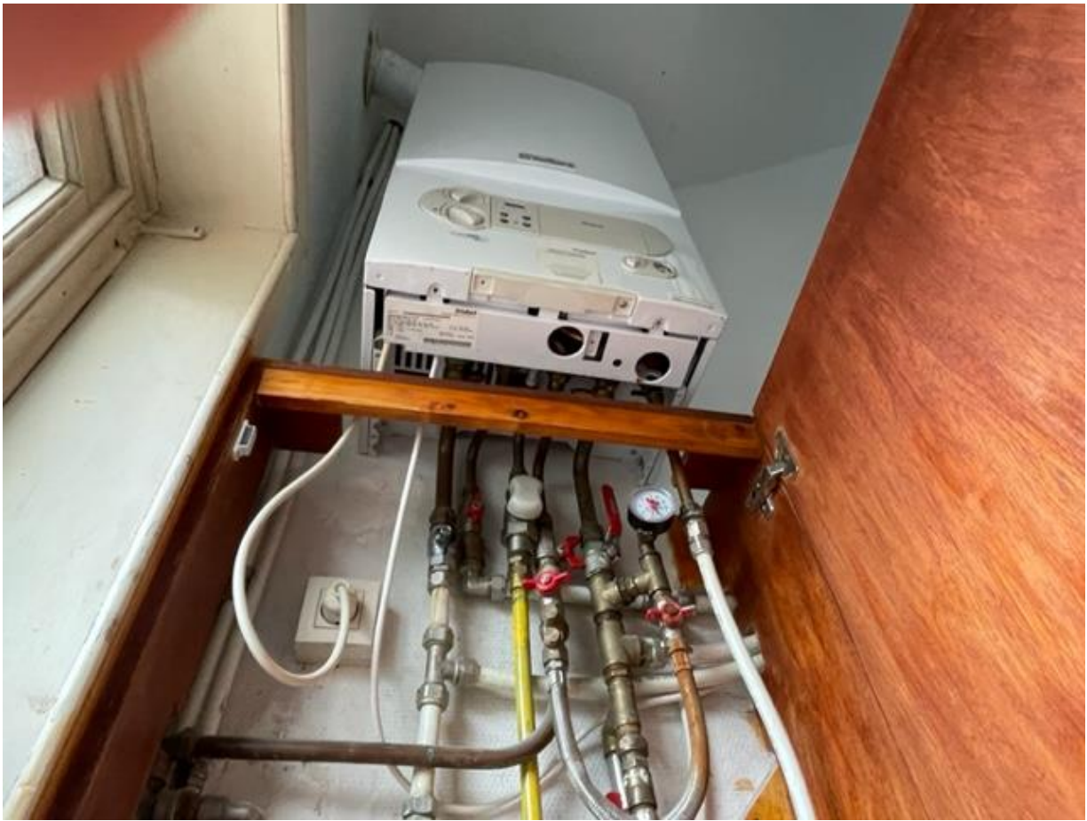
chaudière au palier entresol 1°/2°
