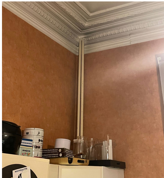
Figure 9 - tuyaux chauffage à mettre dans un cash
